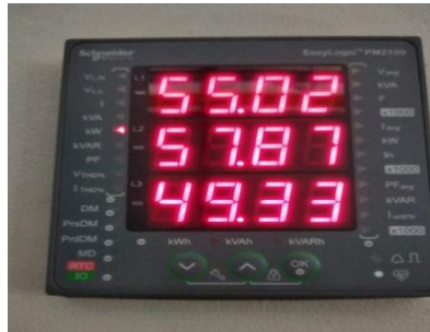
Gambar 24. Power meter yang ada di motor listrik
