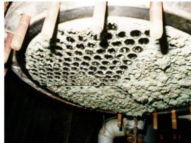
Gambar 2.5 Fouling pada Heat Exchanger
