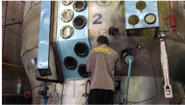
Gambar 4.22 Salah satu unit evaporator
