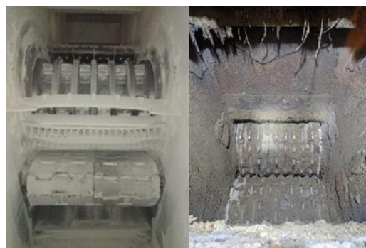
Gambar 4.10 Pengecekan Hammer Mill (Kanan), Pengecekan Rotor Clay (Kiri)
