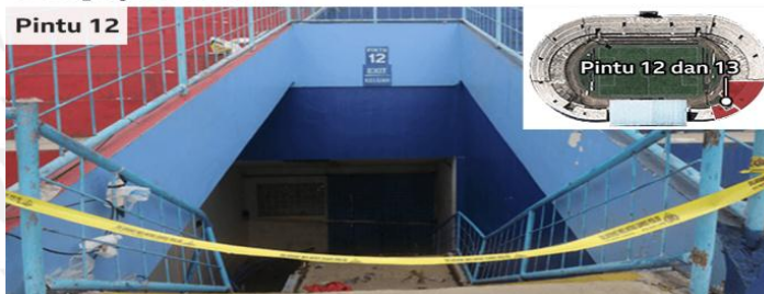
Besi penghalang pintu keluar rusak
