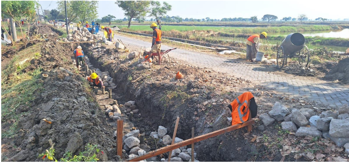
Dokumentasi kegiatan pengawasan K3 pada Pekerjaan TPT (Tembok Penahan Tanah) Peningkatan Jalan Cerme Lor-Punduttrate
