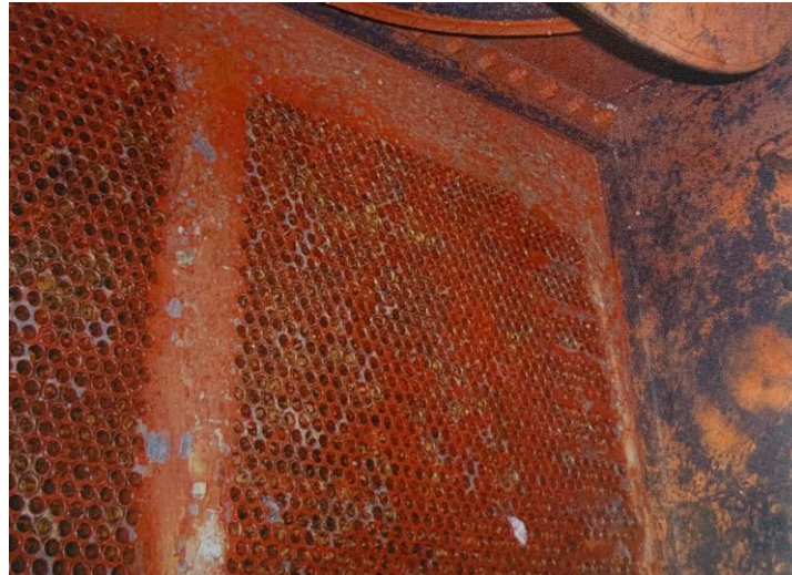
Gambar 3.6 Korosi Akibat Kegagalan Lapis Lindung
