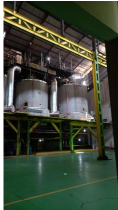
Gambar 3.5 Evaporator pada Stasiun Penguapan
